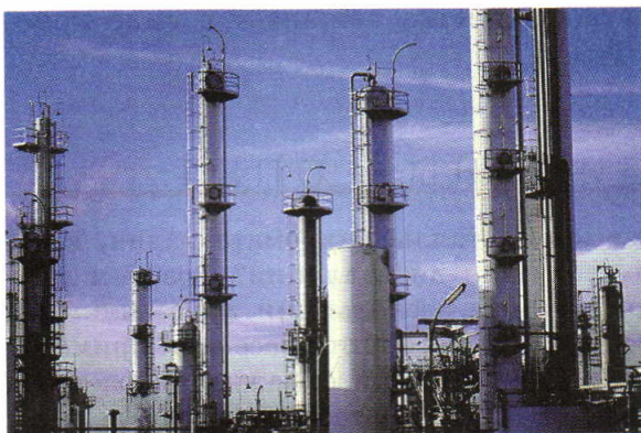
Рис. 89. Ректификационные колонны нефтеперерабатывающего завода
